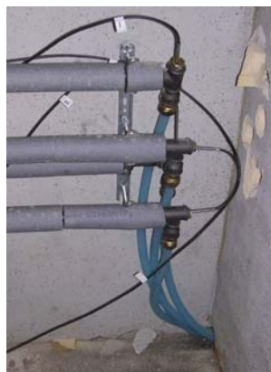
Figur 10. Frem- og returfølere tæt på gulvelementerne
